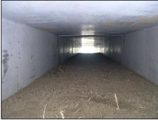
Foto 36. Kahepaiksetele sobiva tunneli põhi peab olema kaetud pinnasega. Foto autor Lars Briggs.
