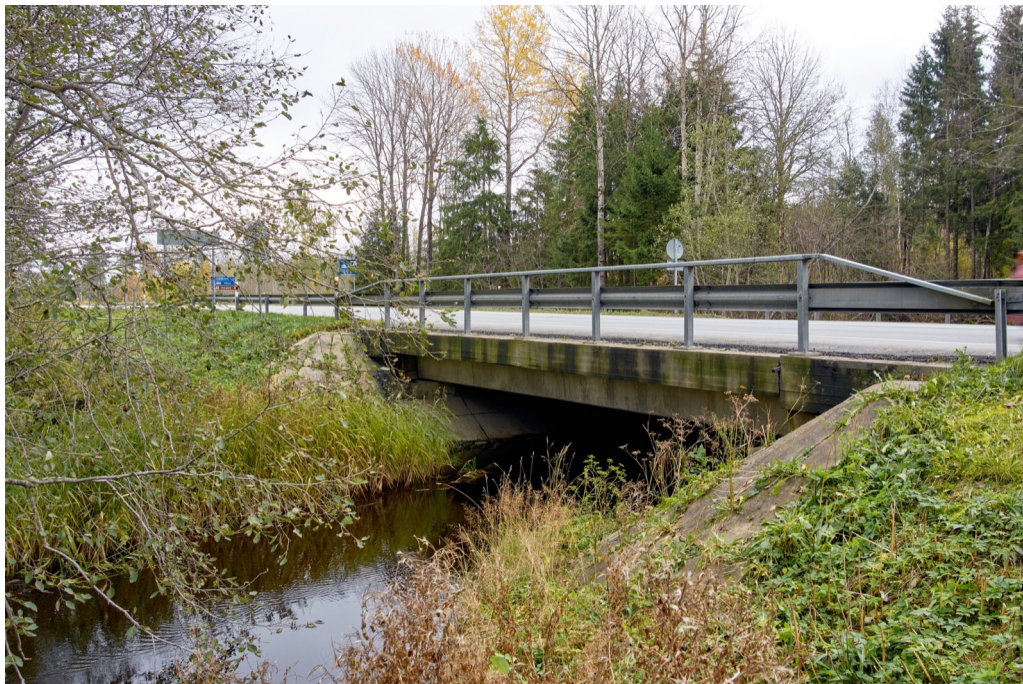
Foto 1-170,15a. Pühajõe silla all km 169,85 puuduvad ulukitele läbitavad kallasrajad.
