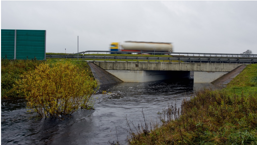
Foto 1-22,50b. Jõelähtme jõe silla all puuduvad kallasrajad.
