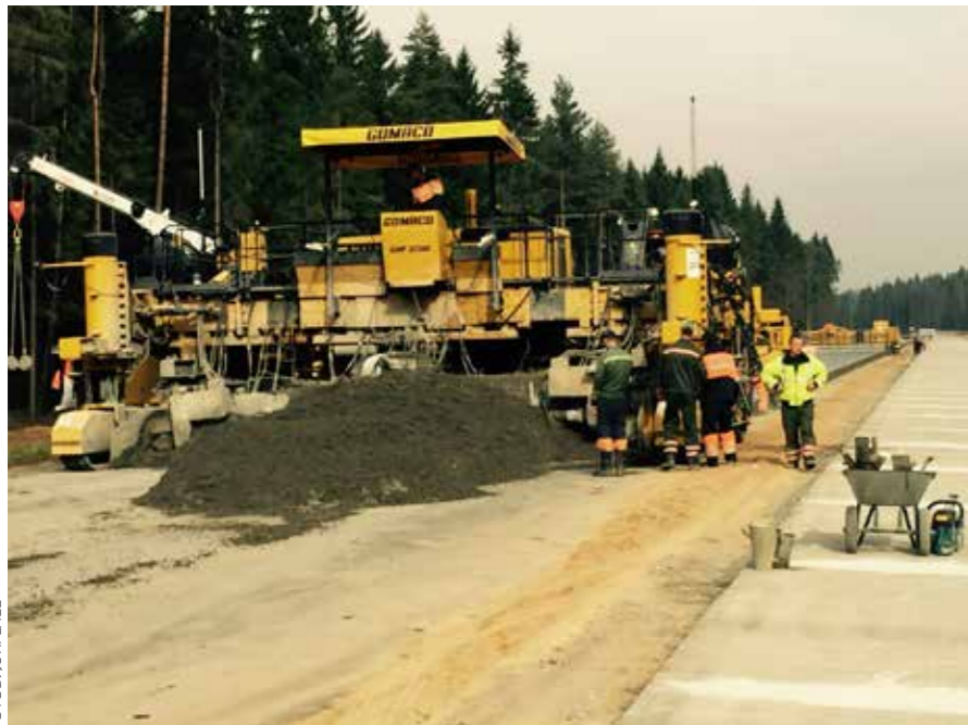
Minski ümbersõidul kõrgele muldele ühekihilise betoontee rajamine. Ristmike ja mahasõitude sagedus 11 kuni 13 km.
