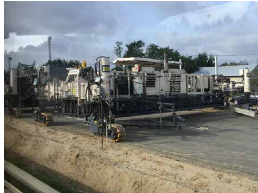
Kahekihilise betoonkonstruktsiooni ehitamiseks vajalik betoonilaotur, pinnatöötluste ja emulsioonipritsi masinad pildile ei mahtunud. Foto on tehtud Poolas.
