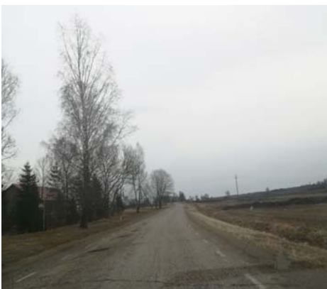
Foto 5. Pärast pinnase stabiliseerimist InfraCretega katselõigul (18,2–18,7 km) oli 2018. aasta ülevaatusel näha palju mahukahanemispragusid, mida lisand pidi vältavalt tsementstabiliseerimisel ära hoidma (katse põhieesmärk). Kahjuks mingit positiivset toimet kallil lisandil ei tuvastatud.
