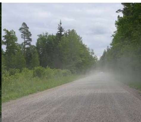
Foto 3. Katselõik nr 7 (14,6.–15,1. km). Toorrapsiõli ja teised kergemad tolmutõrjevahendid on kaks aastat hiljem peaaegu lahustunud ja välja pestud. Võrreldes fotol 2 oleva teega on selge vahe auto möödasõidu korral.
