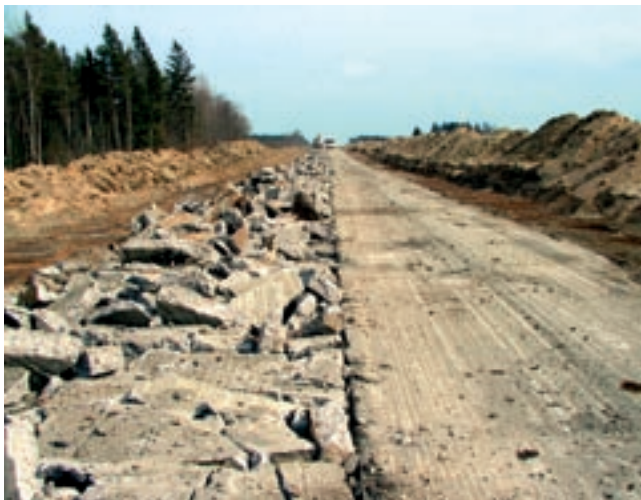
Vanast tsementbetoonkattest pool lõhutud. Foto Veiko Juudas
