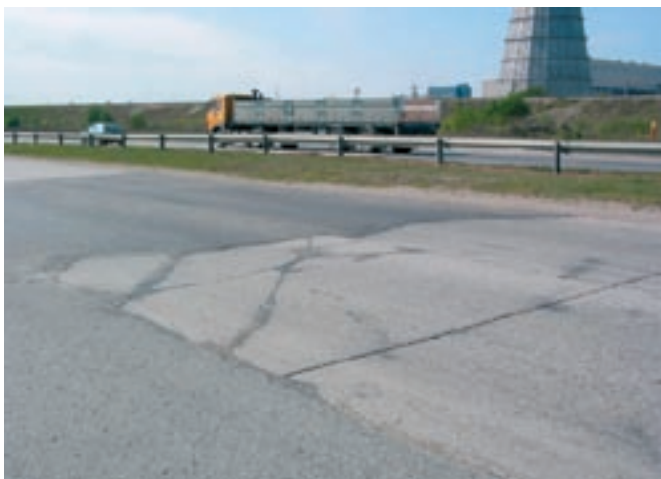
Betoonkatte defektid. Üldiselt on betoonplaadid hästi vastu pidanud, ainult üksikutel lõikudel on äravajumisi ja pragunemist. Foto A. Brakmann
