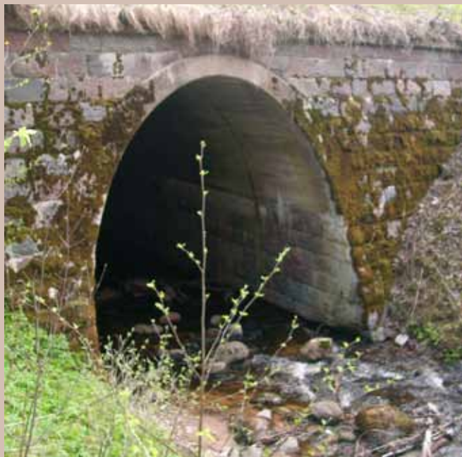
Foto 1. Kolmekuningasild Võrumaal. Tahatud raudkividest ja betoonist võlvtsilla ehitamist alustati hädaabitööde korras 1930. aastate lõpus, kuid lõplikult valmis sild 1940. aastal
