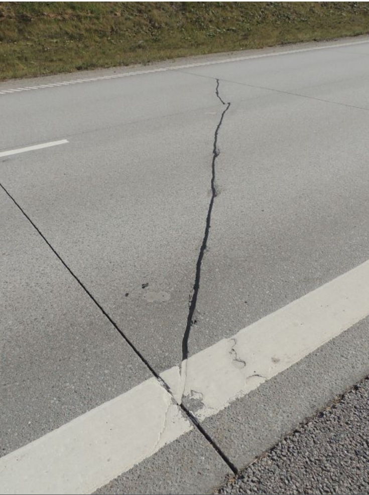
Murdunud betoonplaat, mille praod on täidetud pehme mastiksi- ga, Uppsala. (Foto: Ain Kendra)
