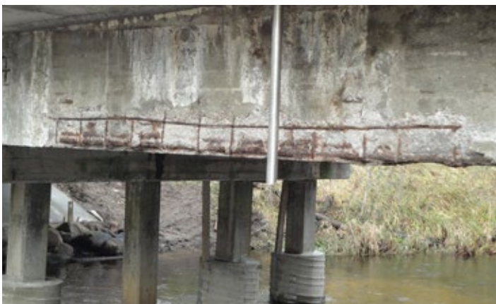
Foto 1. Võrumaal asuv Hutita sild enne rekonstrueerimist.
