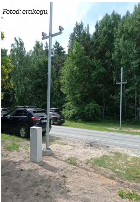
Fotoelektrilised kõrgusandurid tuvastavad sillale läheneva liigkõrge sõiduki.
