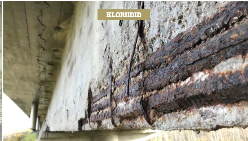
Foto 2. Eesti sildade üks tüüpprobleeme on asjaolu, et kloriidid satuvad peataladele üle sillateki serva valguva vee tõttu, mille tagajärjel võib ebapiisava kaitsekihi korral tekkida märkimisväärseid kahjustusi.
