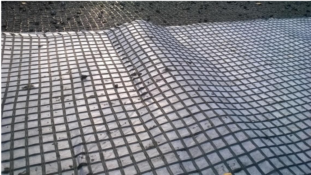
Joonis 31: Asfaldi geokomposiit on paigaldatud ebakorrektselt. Kortse ei tohiks jääda ning see on ka põhjuseks miks tuleb kasutada spetsiaalset geosünteedi laoturit.
