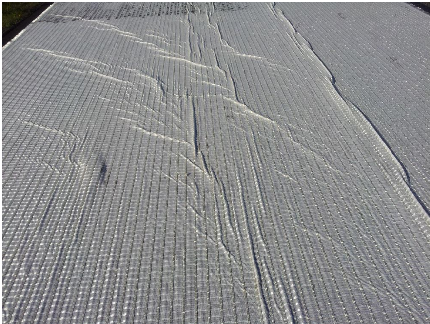
Joonis 30: Asfaldi geokomposiit on paigaldatud ebakorrektselt. Volte ei tohiks jääda ning see on ka põhjuseks miks tuleb kasutada spetsiaalset geosünteedi laoturit.
